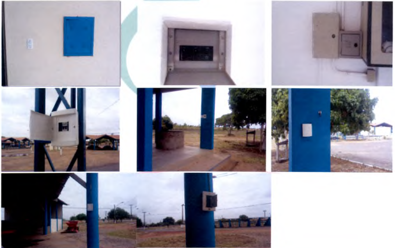
Fotos recentes das caixas de distribuição de energia
